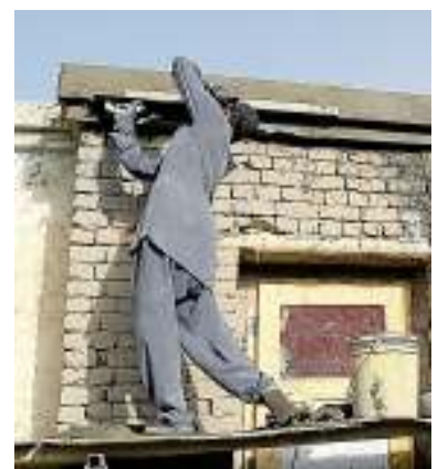
Zuletzt wurde das Schulgebäude verputzt. Auch die Fenster und Türen sind neu. Als Nächstes soll das Außengelände gestaltet werden.
